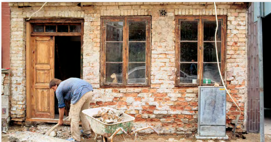
Fig. 19. Fasaden åt gatan med murverk i bedrövligt skick efter cementputs på 1950-talet. Fasaden lagades upp innan den putsades med ett hydrauliskt kalkbruk. – Foto: Viveca Ohlsson, Malmö Museer.
